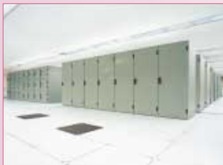
耐震設計のサーバラック
