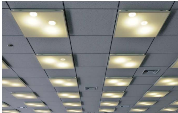
全館LED照明 6,201個配置
