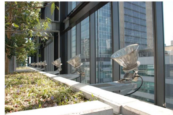
屋上外周を高木による緑の壁面にし 投光器もLED照明を使用
